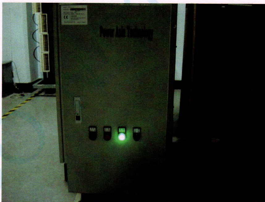
圖片 8 冷卻水泵使用之變頻控制系統
